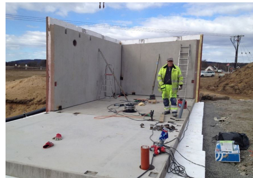
Ny tryckstegringsstation för dricksvatten (2013).
