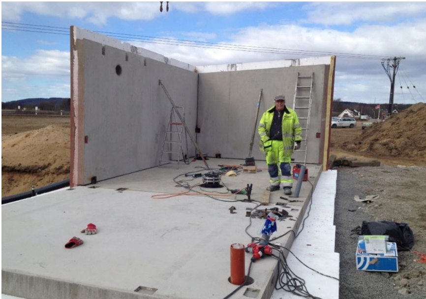
Ny tryckstegringsstation för dricksvatten (2013).
