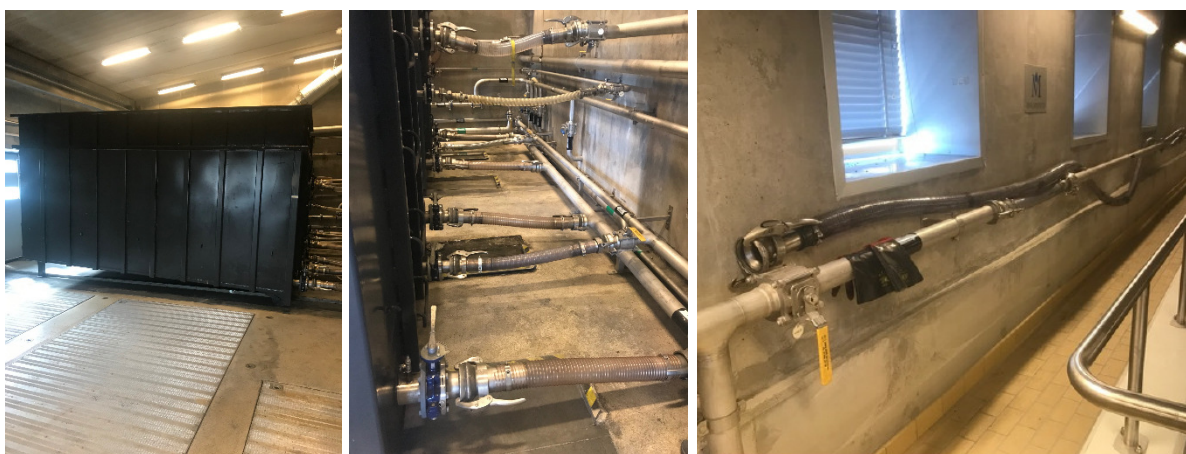
Figur 20. Bilden till vänster visar en av två containrar för lagring av GAK. Bilden i mitten visar tillhörande ledningssystem för vatten respektive GAK-slurry. Bilden till höger visar delar av ledningssystemet för fyllning av GAK inne i filterhallen.
