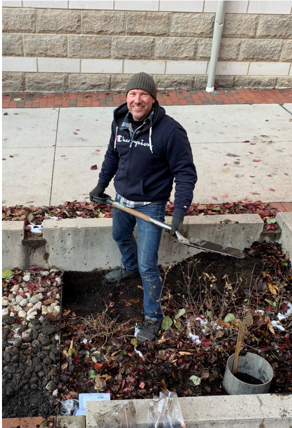
Figur 13. Provtagning av filtermaterial i biofilter för dagvattenrening.
