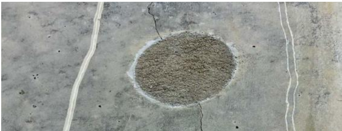
Bild på igengjutet formstag. Sprickor syns i anslutning, en risk som bör beaktas.
