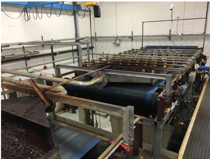
Figur 1. Silbandspress på slamavvattningsanläggningen på Rönneholms mosse.
