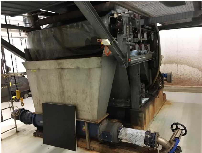
Figur 2. Silbandspress med torrslampump i förgrunden.
