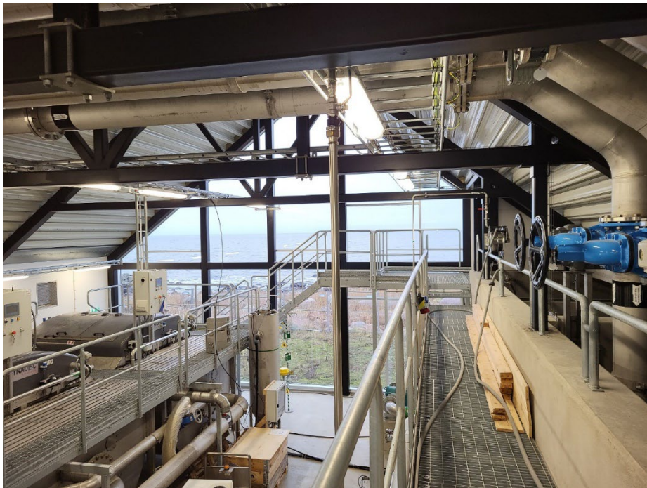
Reningsverket i Kivik som utvärderas i ÅÄÖ-projektet.
