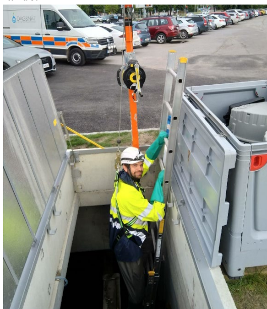
Figur 15. Montering av provtagningsutrustning.
