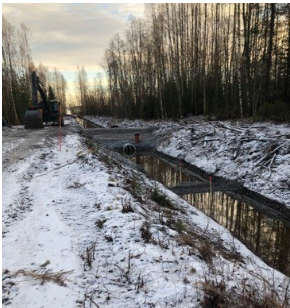
Figur 22. Testsite Luleå – fullskalig anläggning, Storheden.
