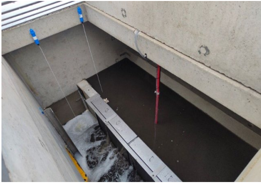
Bild 8. Utloppssektion av EcoVault anläggningen under ett regn.
