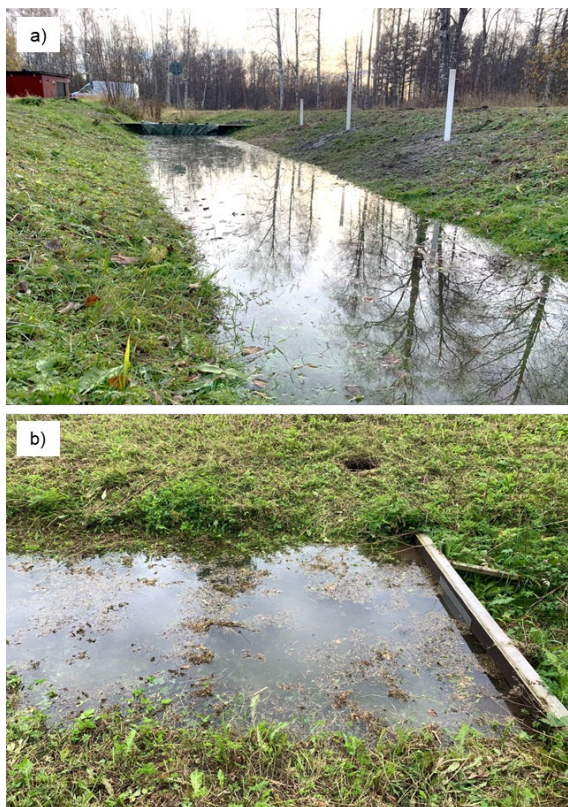
Bild 14. a) Översvämmat svackdike. b) Installerad flödeskontroll vid utlopp
