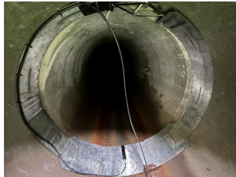
Bild 17. Installerad flödes- och nivågivare i 1200 mm dagvattenrör
