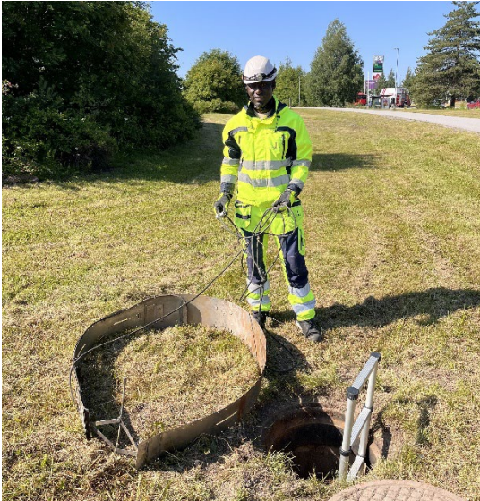
Bild 18. Flödessensor redo för installation i en 1400 mm dagvattenledning
