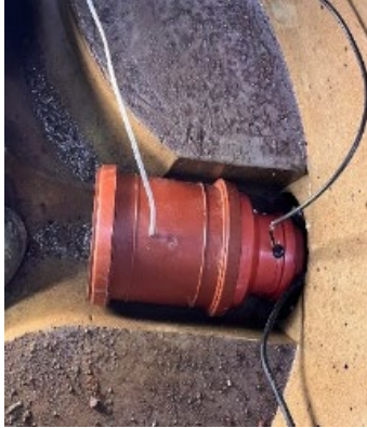
Bild 24. Mikrofon och högtalare i skyddande konstruktion placerad i nyligen anlagd avloppsledning.
